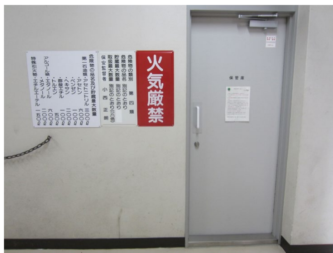
図1 本学の危険物屋内貯蔵所
