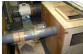
写真3 外気取り込み測定用換気装置
